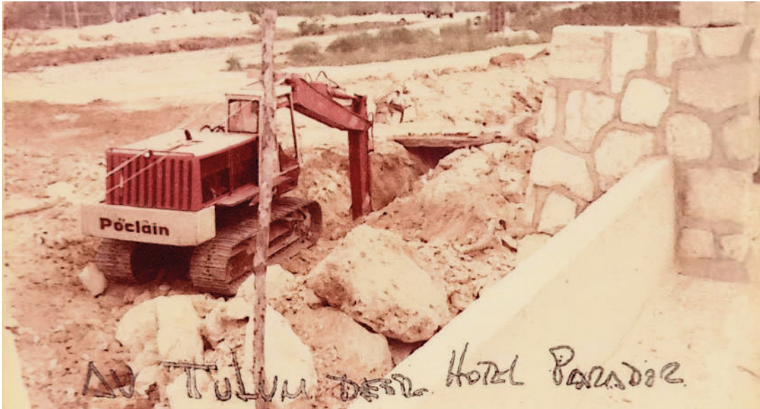
Esta gráfica, captada desde la obra negra del hotel Parador, muestra con claridad que avenida Tulum seguía siendo una vía sin pavimentar a fines de 1973. (Jorge Ávila Mariño)
